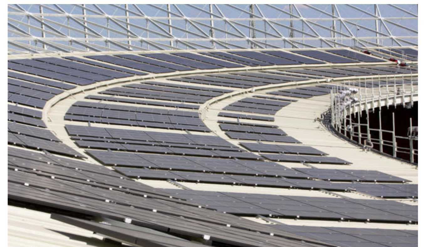
9.300 PV-Module am Dach des Ernst-Happel-Stadions in Wien machen es zum ersten emissionsneutralen Stadion Europas.
